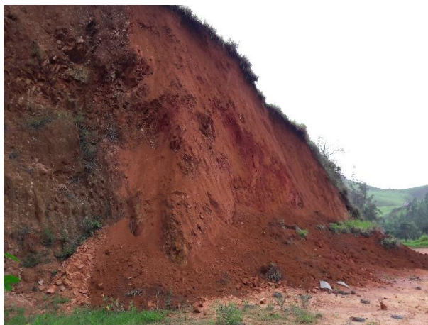
Figura 35. Deslizamento de massa na seção final da CGH Alto Glória (margem esquerda).
