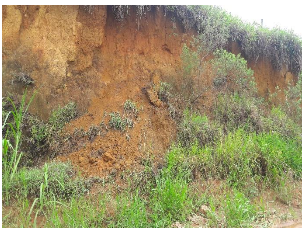
Figura 36. Deslizamentos de massa na seção final do aproveitamento, margem esquerda e direita do rio Glória. Imediações abaixo do transecto previsto para a implantação da casa de força.
